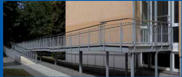
Freien Zugang ohne Barrieren haben Mieterinnen und Mieter seit kurzem Auf dem Kiewitt 1 – 2. Hier ließ die GEWOBA nach Anfragen aus der Bewohnerschaft einen barrierefreien Zugang mit beleuchteter Rampe und Automatik für inklusive Schüsselschalter installieren.
